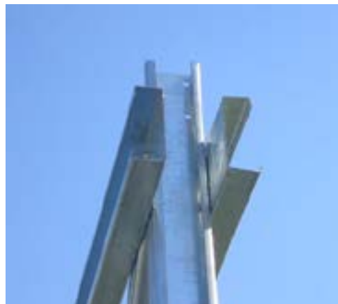
2. ábra. LindabTruss rácsostartó alapelve: osztott szelvényű övrúd, közé helyezett rács- és oszloprúd
